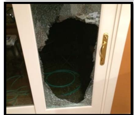
Los Arabis Circle damaged door
